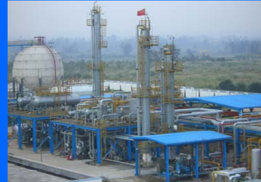
Mini LNG Plant
